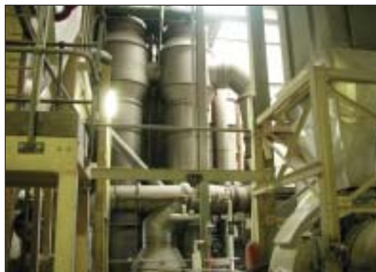
Stork evaporation plant, cap.: 21 ton per hour Stork indampinstallatie, cap.: 21 ton per uur
