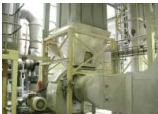
starch dryer (4) with: filter cabinet, screw conveyor, 2 Powtek Ltd. filters, etc. zetmeeldroger (4) bestaande uit: filterkast v.v. schroeftransporteur, 2 Powtek Ltd. filters, etc.
