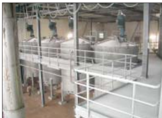
Stainless steel mixing tank (35-V-01), cap.: 30.3 m3 l., with Jongia mixer Rvs mengtank (35-V-01), cap.: 30.3 m3 ltr., met Jongia roerwerk
