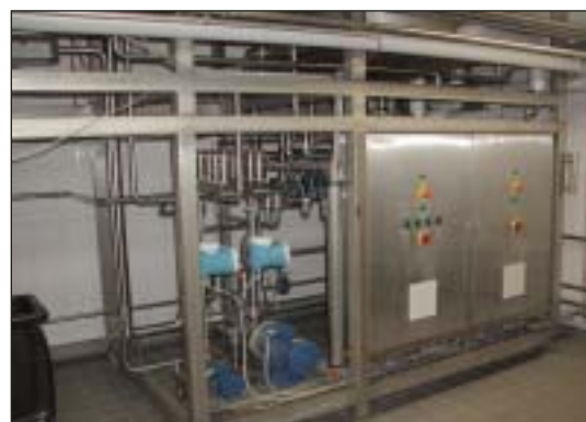
pompinstallaties / regelapparatuur pump units / control equipment Pumpen / Kontrolle Apparatur
